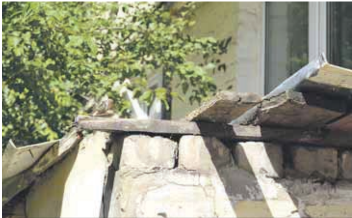
Крыша над входом в подвал 77-го дома не выдерживает никакой критики
